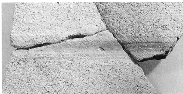
2 同 突帯剥離部
