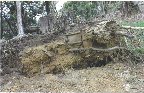
3 根起き箇所1 調査状況 (南東から)
