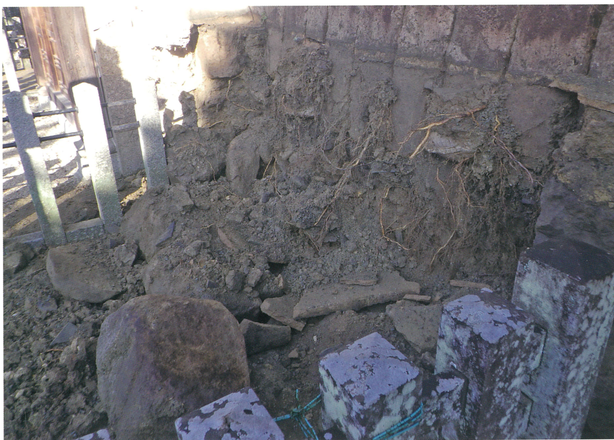
2 東区 石積崩落状況（南東から）
