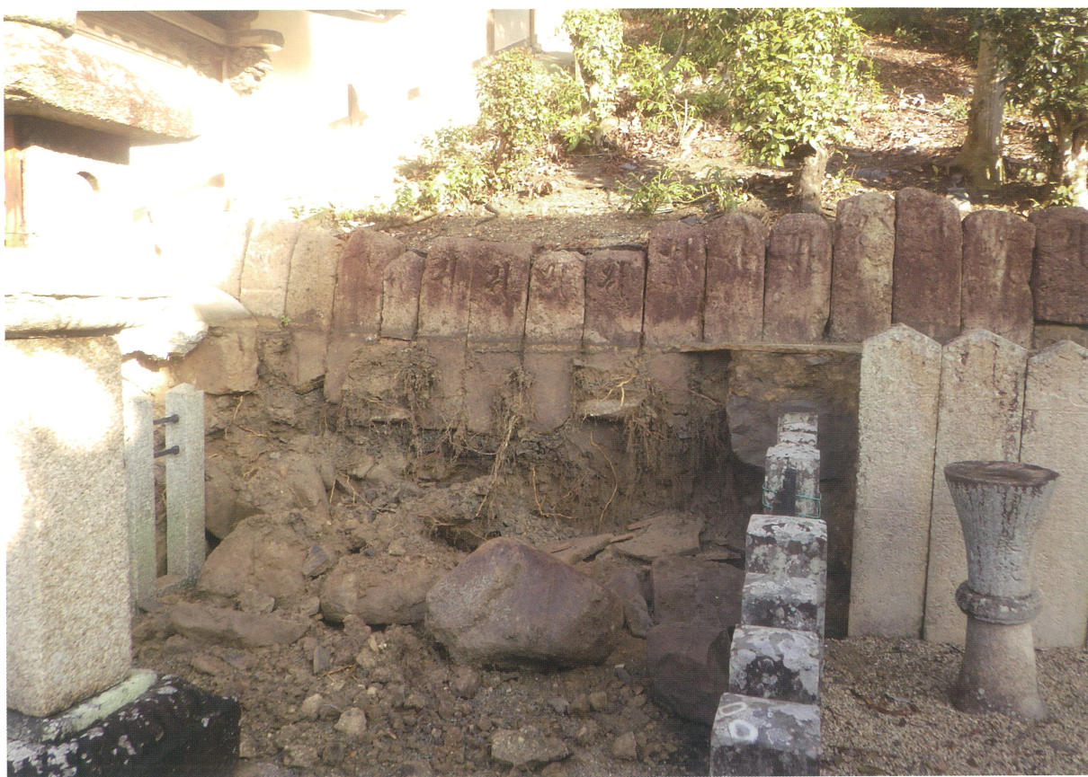
1 東区 石積崩落状況（南から）
