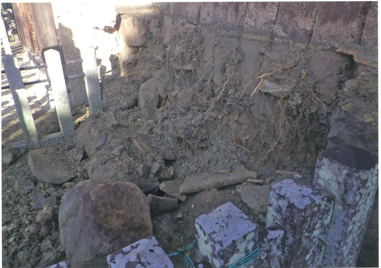
2 東区 石積崩落状況（南東から）
