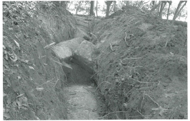
2 北部舗石上の崩落石 (12-25)
