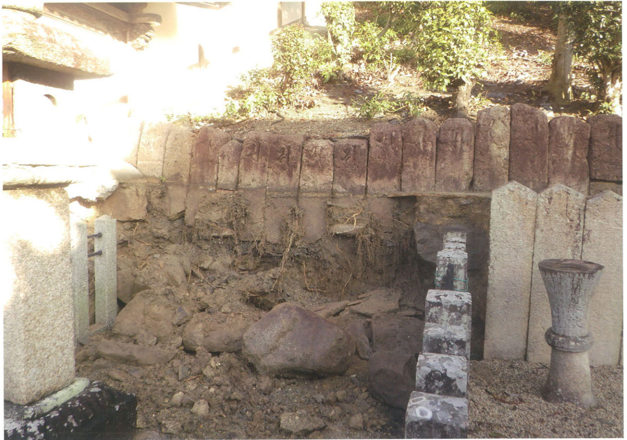
1 東区 石積崩落状況（南から）
