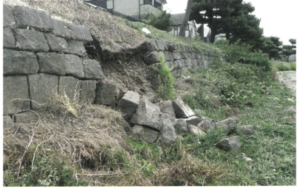
2 石積 崩落状況 (北西から)
