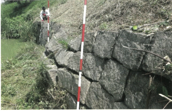
1 石積 孕み状況 (南東から)
