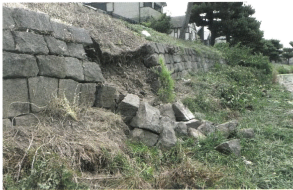
2 石積 崩落状況 (北西から)
