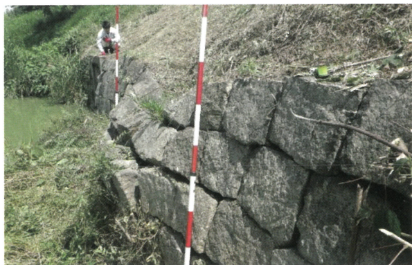
1 石積 孕み状況 (南東から)
